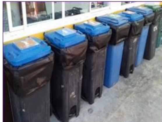
Figura 28. Tipo contenedores instalados en el área operativa.
